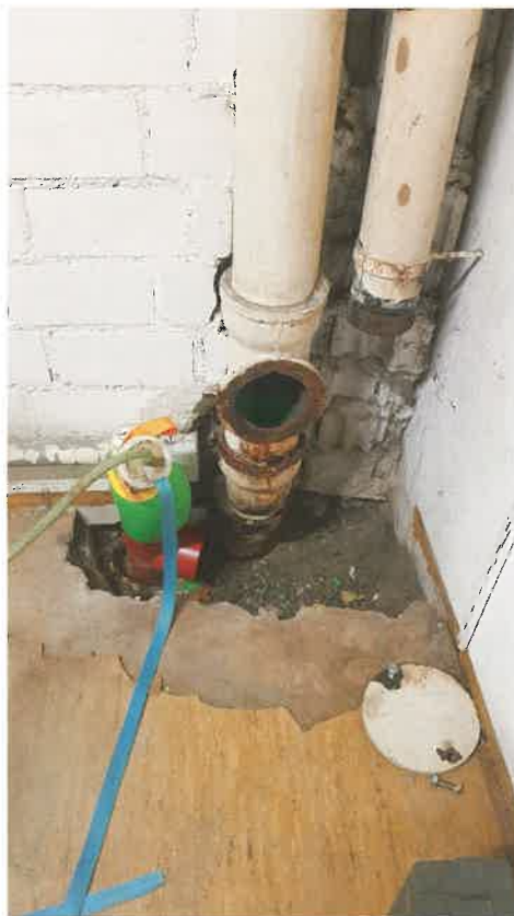
Bild 1: Die Liner werden in die Öffnungen der Leitungen in einem der Klassenzimmer invertiert
